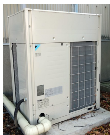
エアコン室外機
