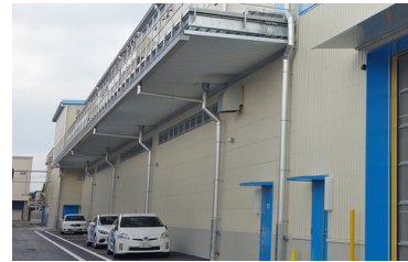
室外機を上置き、その下は駐車スペース。
